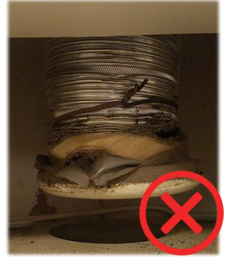
Poistoilmaventtiili kurkkuputkella, jätetty piiloon yläsokkeliin. Kurkkuputkea ei saa käyttää! Poistoilmaventtiili tulee jättää näkyville.
