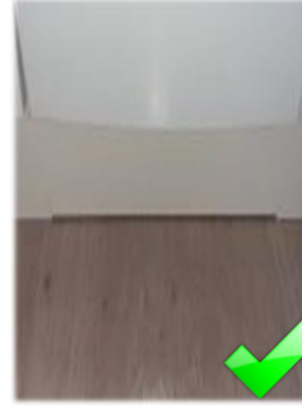
Astianpesukoneen edessä sokkelissa lovi vuotovesien esilletuomiseksi
