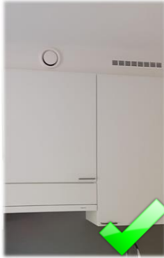
Liesituuletin aktiivihilisuodattimella. poistoilmaventtiili seinässä sekä tuuletusritilä liesituulettimelle
